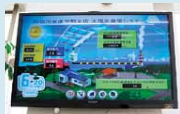
太陽光発電システム
